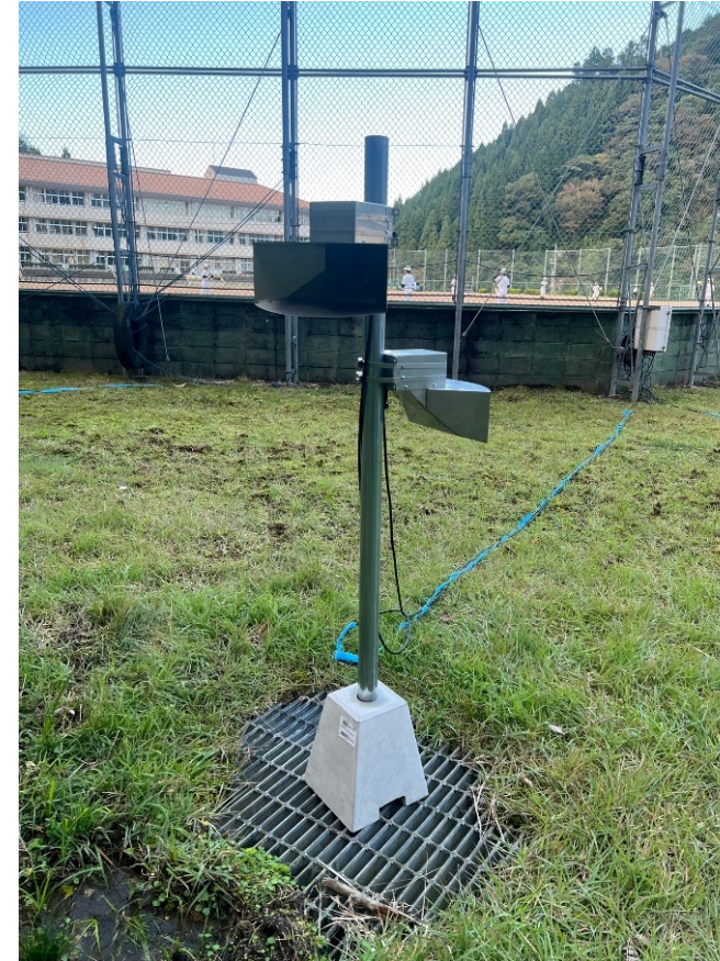
バックネット裏に 設置している 屋外用スピーカー
